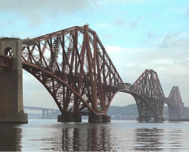
Puente sobre el estuario del río Forth (Firth of Forth) en Escocia, de Baker y Fowler
